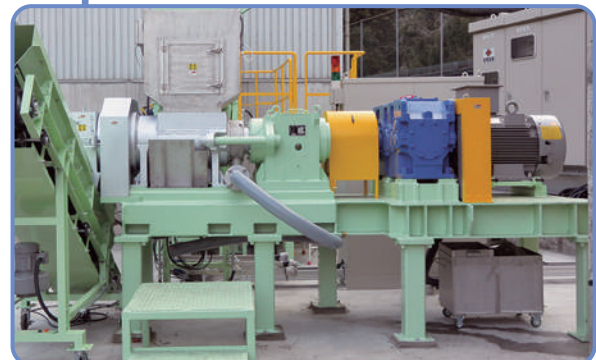
■ 脱水固形機 水分を多く含んだパルパー粕等を 2軸スクリーにて脱水固形します。
