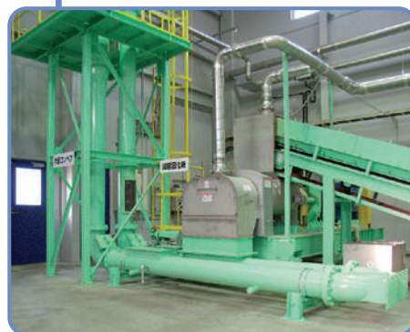
■減容固化機 (DP-30S) 押し出し成型された R.P.Fが排出されます。
